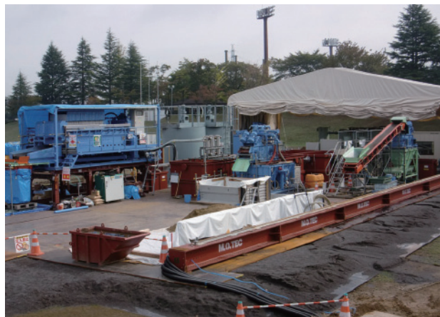
プラント稼働状況
