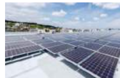
〈導入設備の一例〉太陽光パネル
