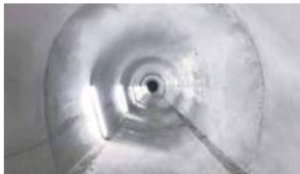
原町発電所新導水路
