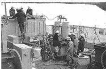
左が浮上分離濁水処理装置
