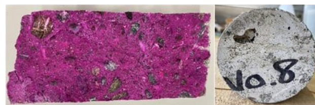
写真-7 No.8 の中性化状況 (コールドジョイント)
