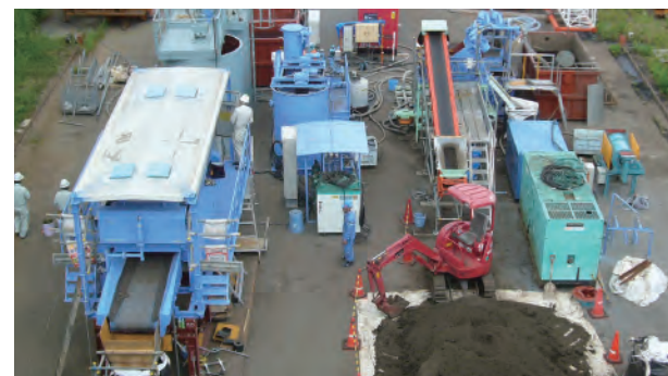
現場搬入に向けた試運転調整
