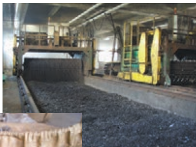
発酵乾燥設備
