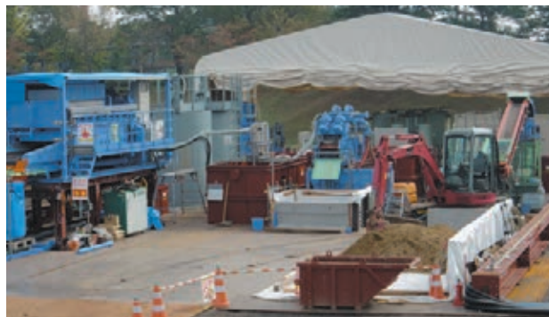
除染・減容化プラント全景(福島県泉崎村)
