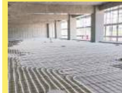
躯体に蓄熱させるTABS (躯体蓄熱式の放射冷暖房システム)用配管敷設
