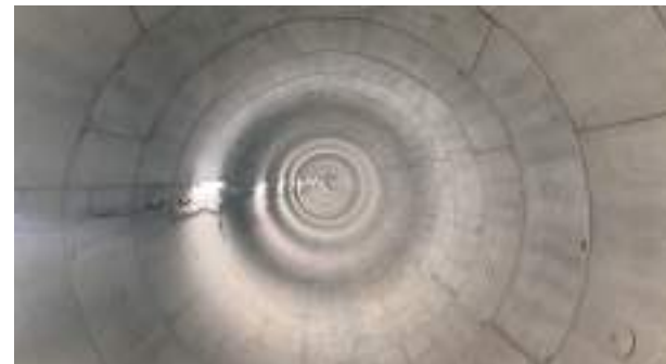
地域を守る雨水幹線管渠
